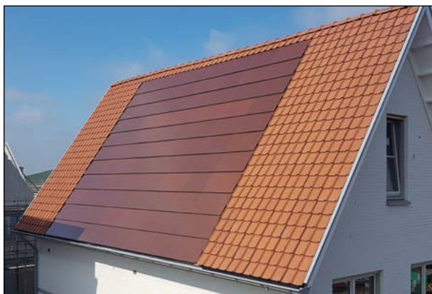
Pannelli fotovoltaici integrati, montati in sostituzione di porzioni del manto di copertura
