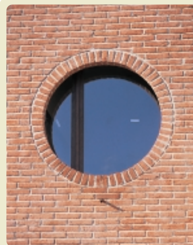
FINESTRA CIRCOLARE CON DIAMETRO 120 CM, POSTA DAVANTI A UN SERRAMENTO QUADRATO DI DIMENSIONI MAGGIORI
