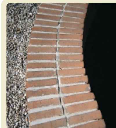
LA POSA SENZA FILI DI CONTROLLO PORTA AD UN'ESECUZIONE POCO REGOLARE DI GIUNTI E ALLINEAMENTI
